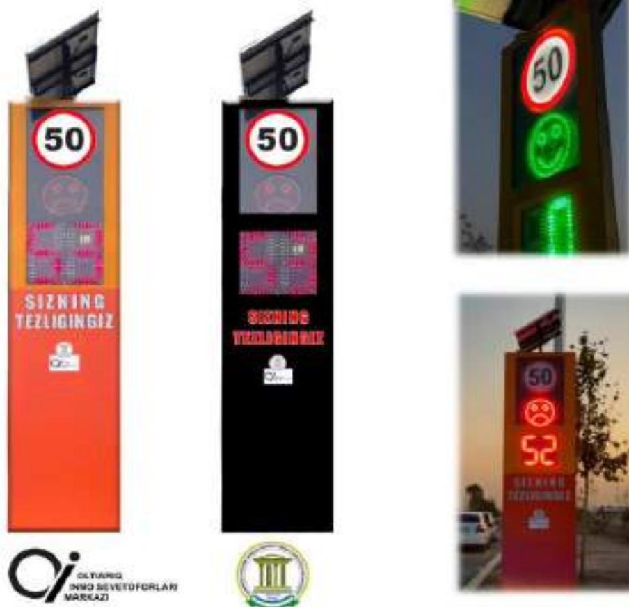
Рис 1. Фото установленной Умного дорожного знака на территории в городе Ферганы.
